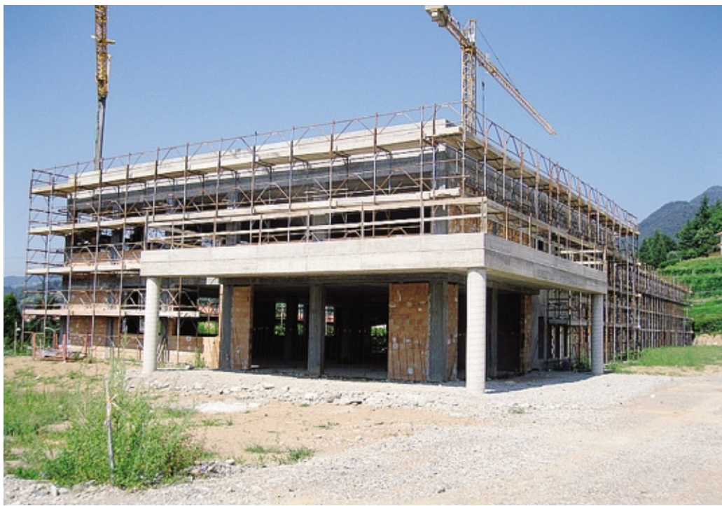
Il cantiere della nuova scuola a Villa d'Almè: i lavori procedono spediti e la fine è prevista per l'agosto 2016
